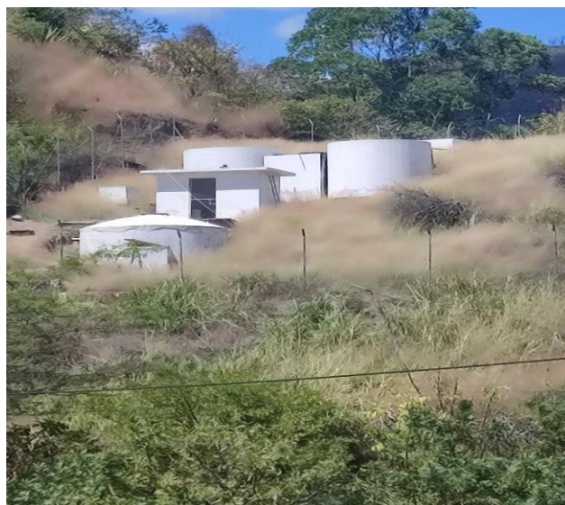
Imagen 32. Sistema de agua potable y entubada en el barrio Rancho Alegre – Sacapalca Nota. Fotografía tomada en estudio de campo por Equipo Técnico Consultor (2024).
